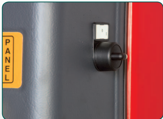
➤ Interrupteur principal Hauptschalter
